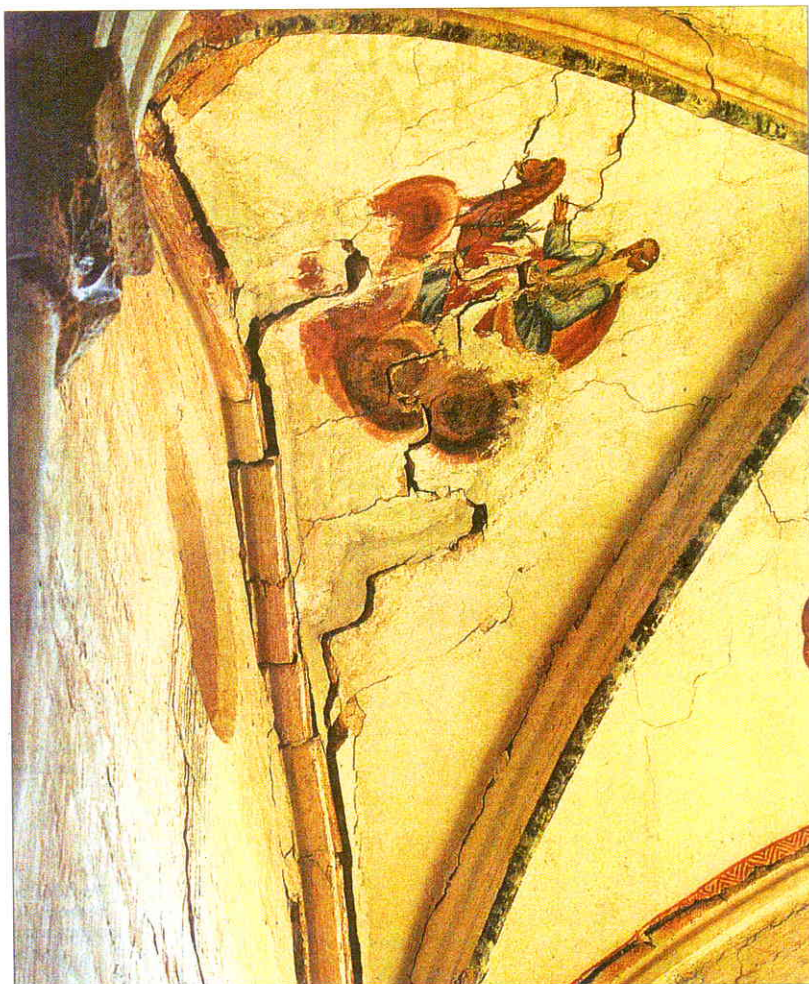
En las bóvedas del templo han aparecido numerosas grietas. / ÁNGEL AYALA
